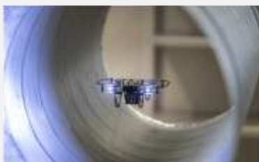
ダクト 配管内部
